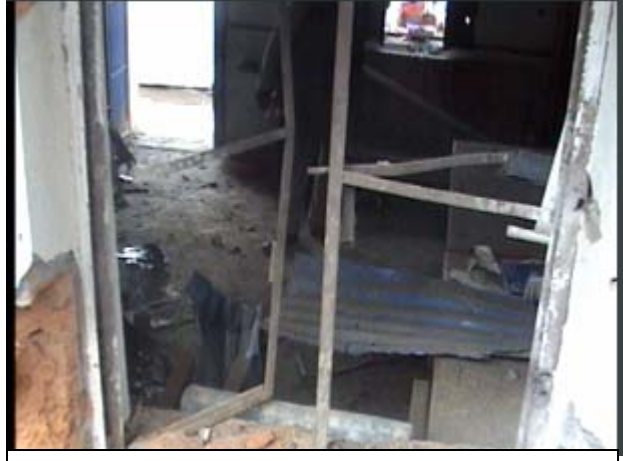
बमद्वारा क्षतिग्रस्त बाघ भैरव उच्च मावि भवन
